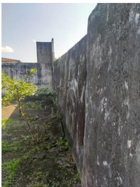
Muro do Fundo Danificado
