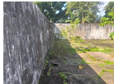
Muro do Fundo Danificado
