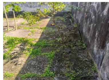
Recalque da Pavimentação
