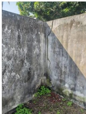
Muro do Fundo Danificado
