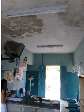
Infiltração na Laje
