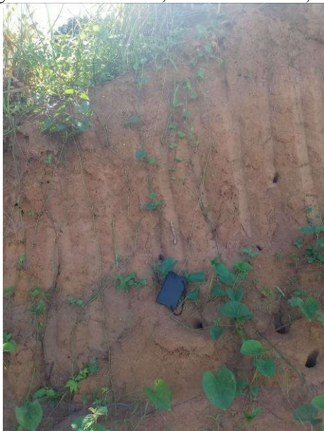
Perfil de solo em corte de morro no terreno vizinho a locação.
