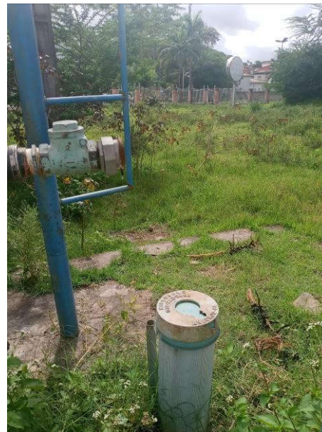
Poço Tubular da Prefeitura na Sede municipal. Coord.: 720527m E/ 8822106mS.
