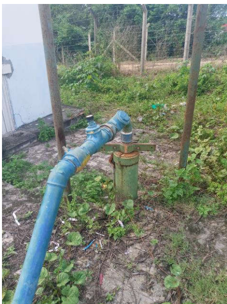
Poço Tubular da Prefeitura na Sede municipal. Coord: 720786 m E/8821746m S
