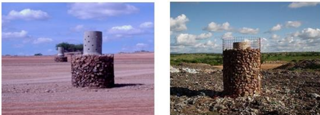
Figura 6:7: Sistema de Drenagem de Gases
