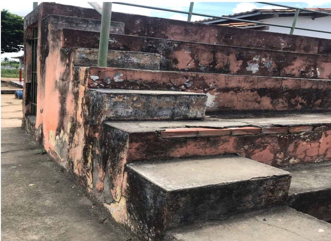
Figura 6: Piso e Espelho da arquibancada a ser reconstruído
