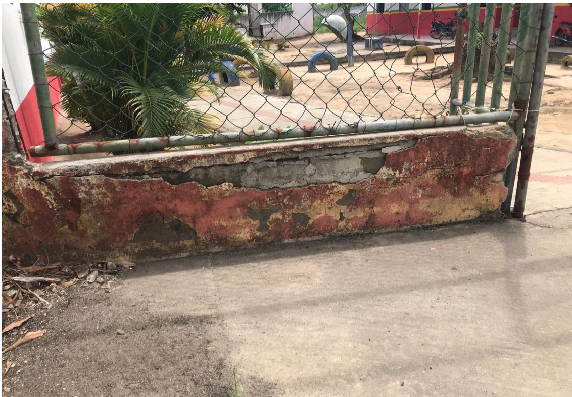
Figura 5: Área de reboco a ser demolida e refeita
