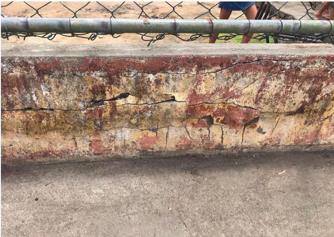
Figura 4: Área de Reboco a ser demolida e refeita
