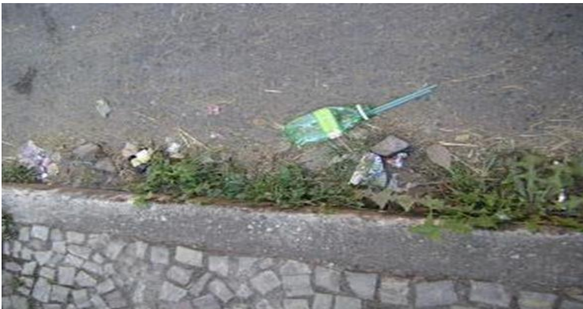
Exemplo de sarjeta necessitando de capinação e raspagem de terra
