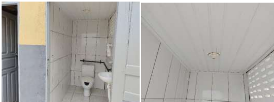
FOTO 04: AMBIENTES INTERNOS DESCRIÇÃO: Necessária revisão da parte elétrica e hidrosanitária FONTE: JOHN ÁLEX – DATA: 26/02/2022
