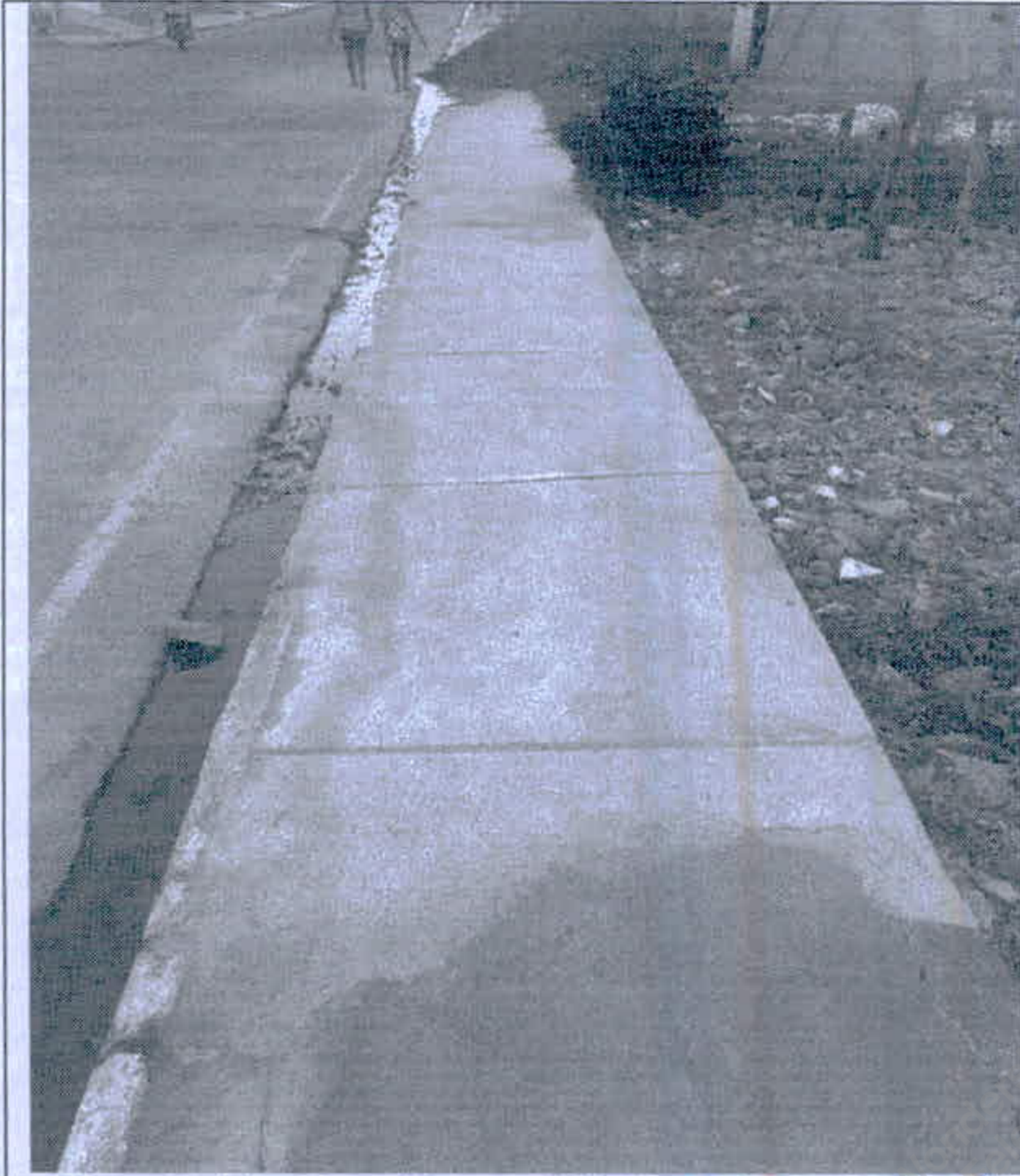
Figura 41 - Rua Petronidio Menezes de Cutia - Demolição de pisos de concreto / Piso de concreto desempolado
