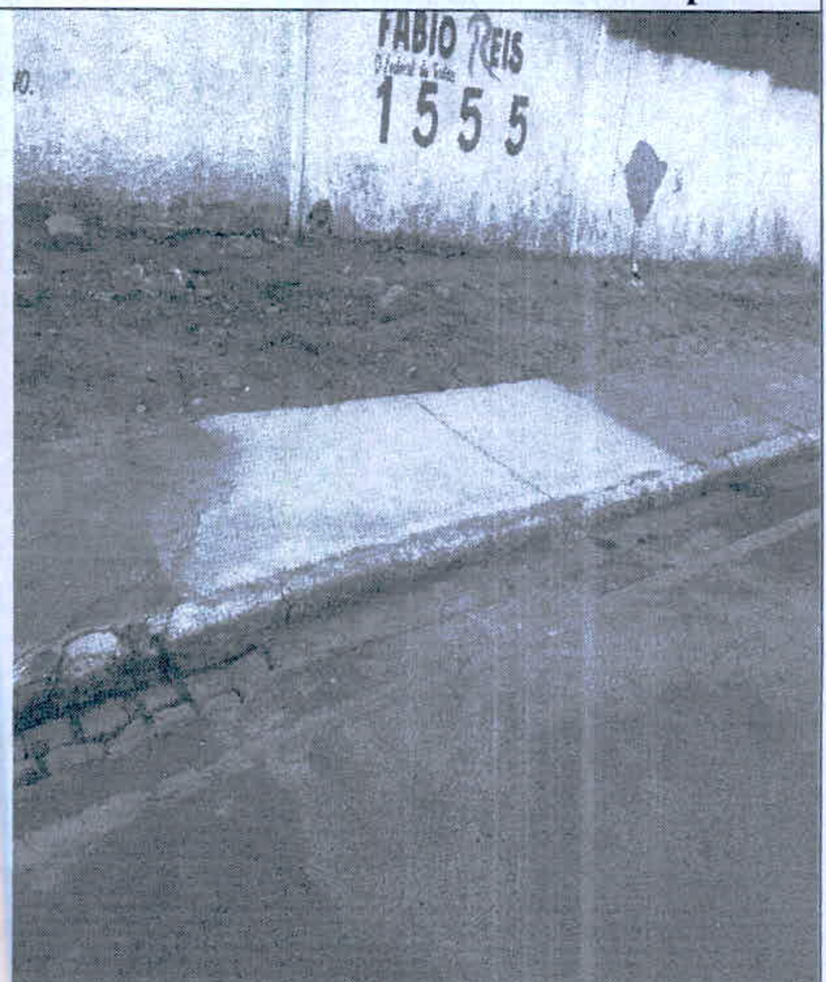
Figura 40 - Rua Petronidio Menezes de Cutia - Demolição de pisos de concreto / Piso de Concreto Desempolado
