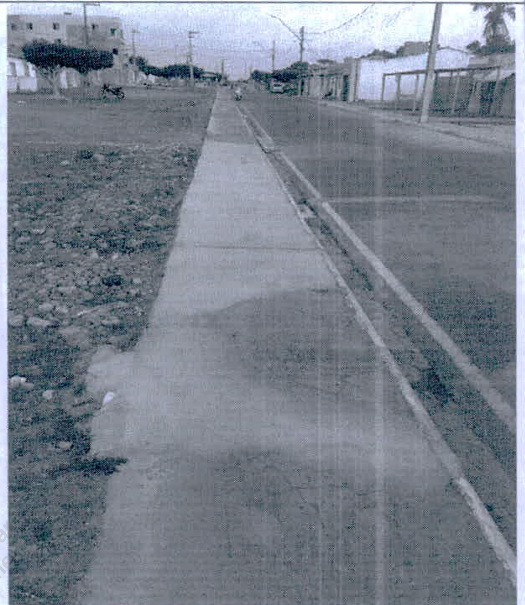
Figura 42 - Rua Petronidio Menezes de Cutia - Demolição de pisos de concreto / Piso de concreto desempolado
