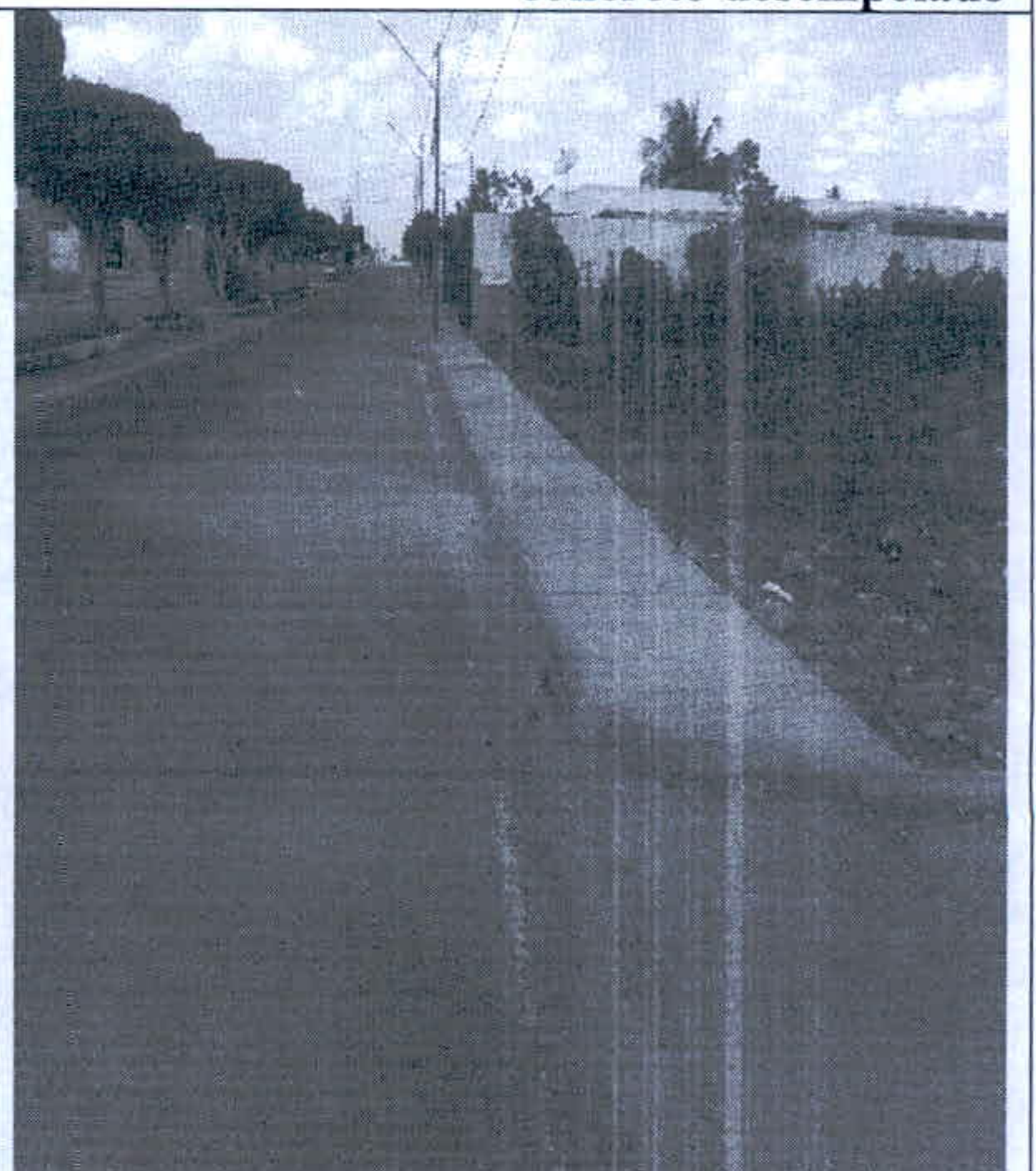
Figura 36 - Avenida Conego Miguel - Demolição de pisos de concreto / Piso de concreto desempolado
