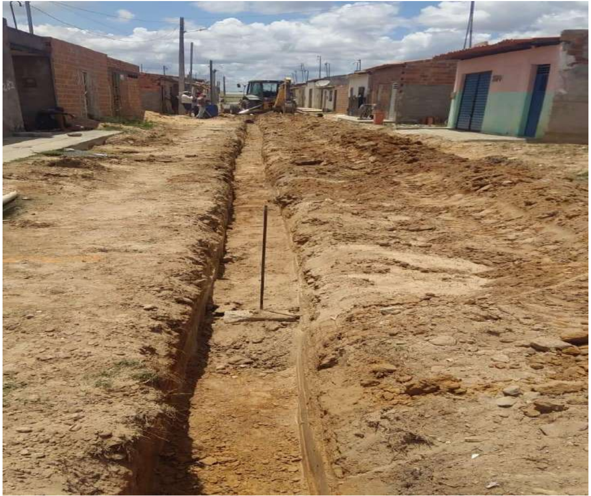
Rua Ampliação da rede de esgoto na Rua João Santos da Silva, Conjunto Irmã
