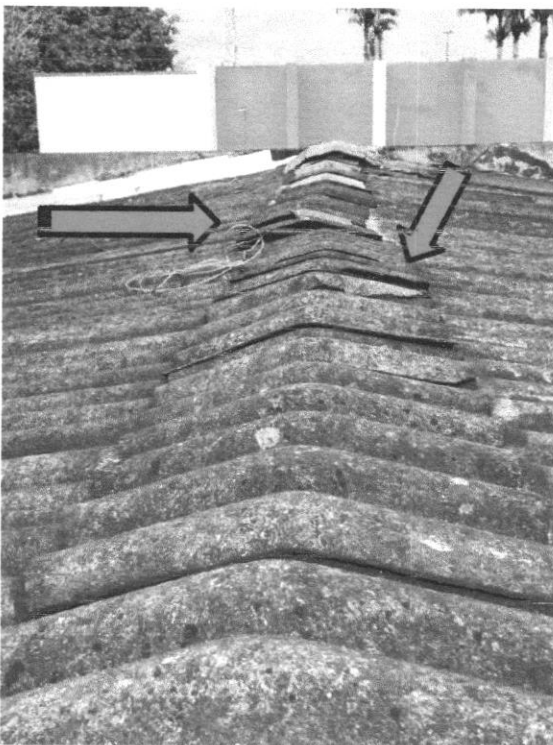
Cumeeira danificadas (Imagem tirada do celular)
