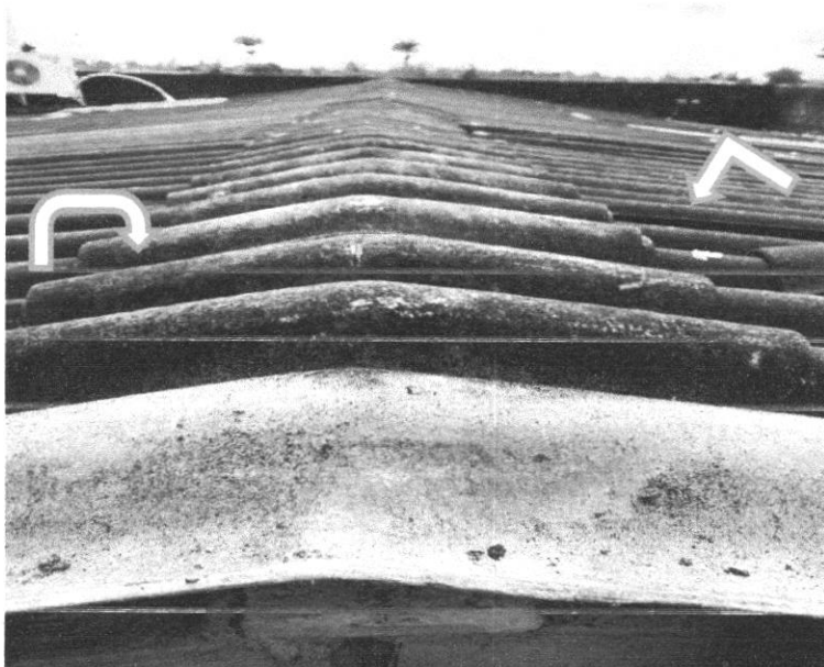
Calhas danificadas, telhas rachadas (Imagem tirada pelo celular).
