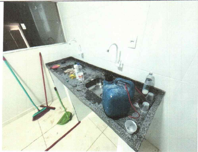
Lavatório com bancada em granito
