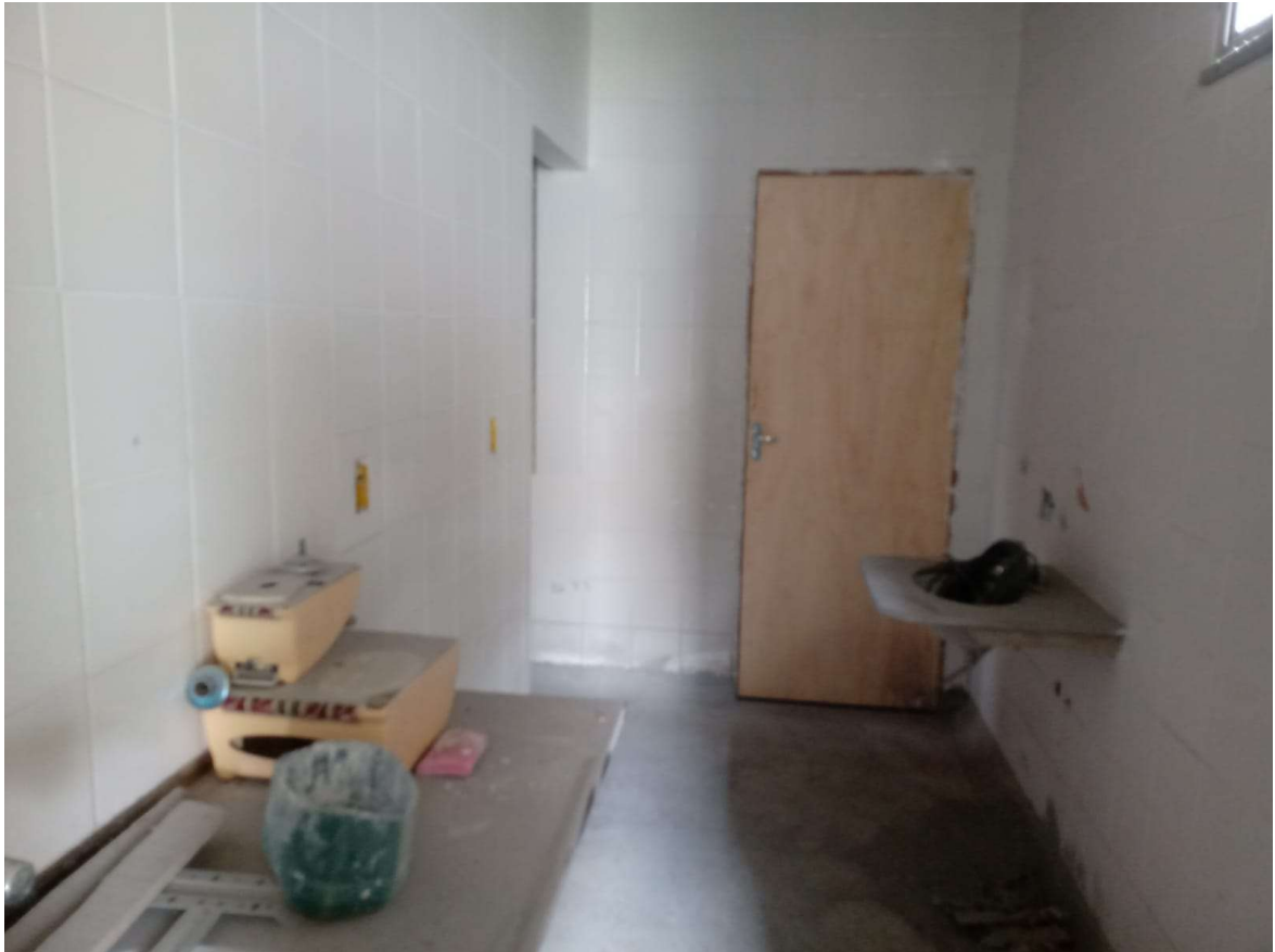
Figura 6: Sala de Lavagem
