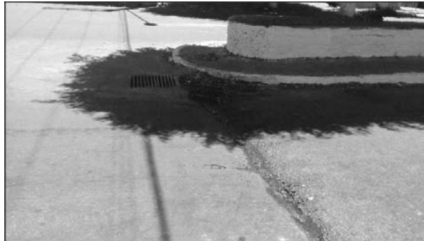
Figura 41: Boca de lobo recebendo águas servidas
