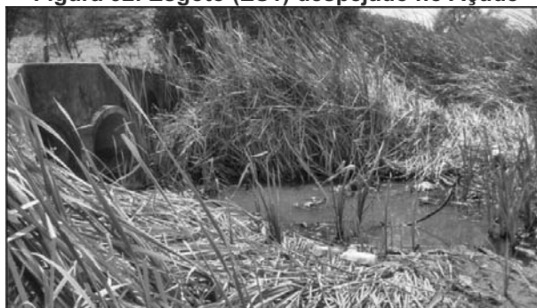
Figura 32: Esgoto (ES1) despejado no Açude
