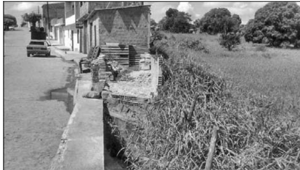
Figura 33: Saída de esgoto (ES2) na Rua Mãe Carira
