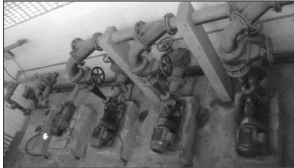
Figura 18: Bombas “booster” da estação elevatória em Carira
