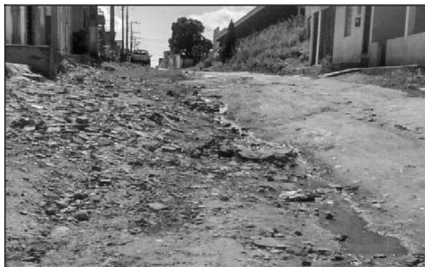
Figura 37: Esgoto a céu aberto no Bairro Vila Nova
