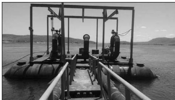
Figura 14: Bombas de Captação em Porto da Folha
