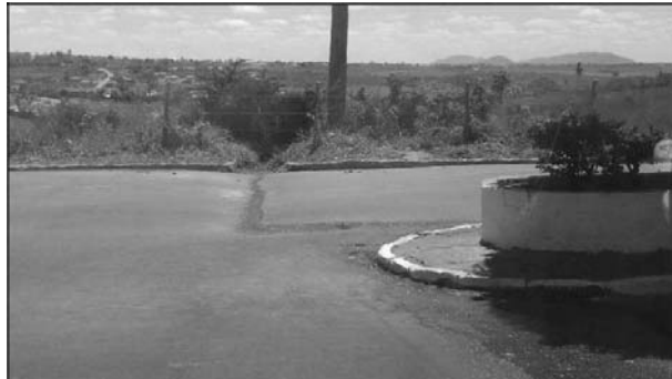
Figura 42: Águas servidas percorrendo o mesmo caminho de água das chuvas
