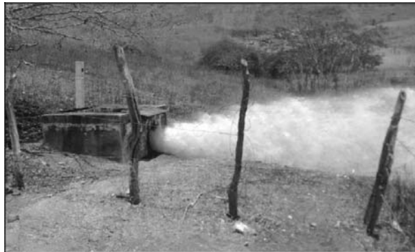
Figura 30: Adutora do Semiárido rompida
