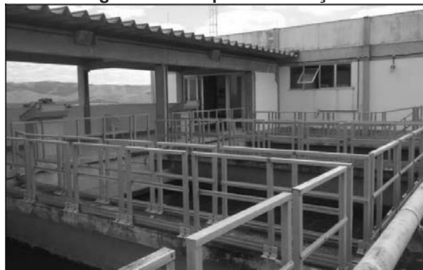
Figura 16: Tanques de filtração.
