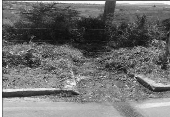
Figura 44: Drenagem por gravidade na Sede Municipal
