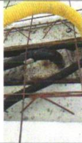
Eletroduto flexível de pvc 25mm, Eletroduto de pvc rígido e Eletroduto flexível de pvc 32mm
